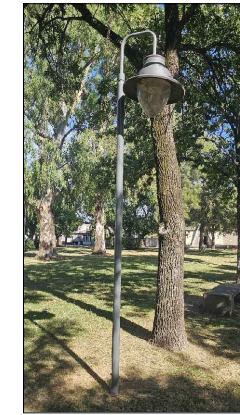
Luminaria existente (16 u en total, se agregan 4 u)
