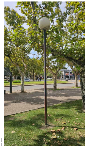
LUMINARIA EXISTENTE A REEMPLAZAR (12 u)
