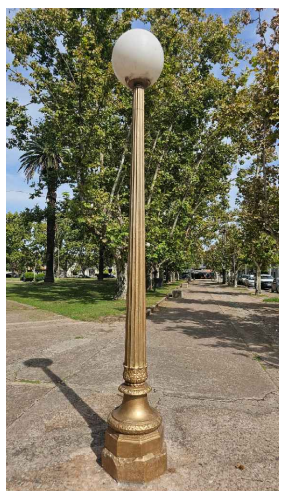
LUMINARIA EXISTENTE (4 u)
