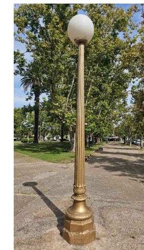
LUMINARIA EXISTENTE (4 u) (en esquinas)
