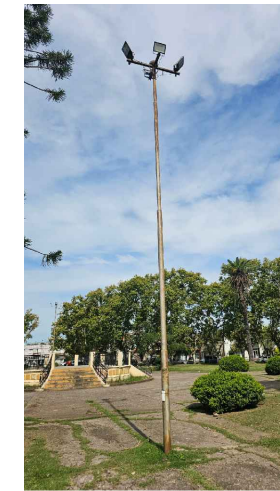
LUMINARIA EXISTENTE (4 u) (en diagonales)
